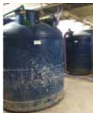
Reservatórios de armazenamento de água condensada
